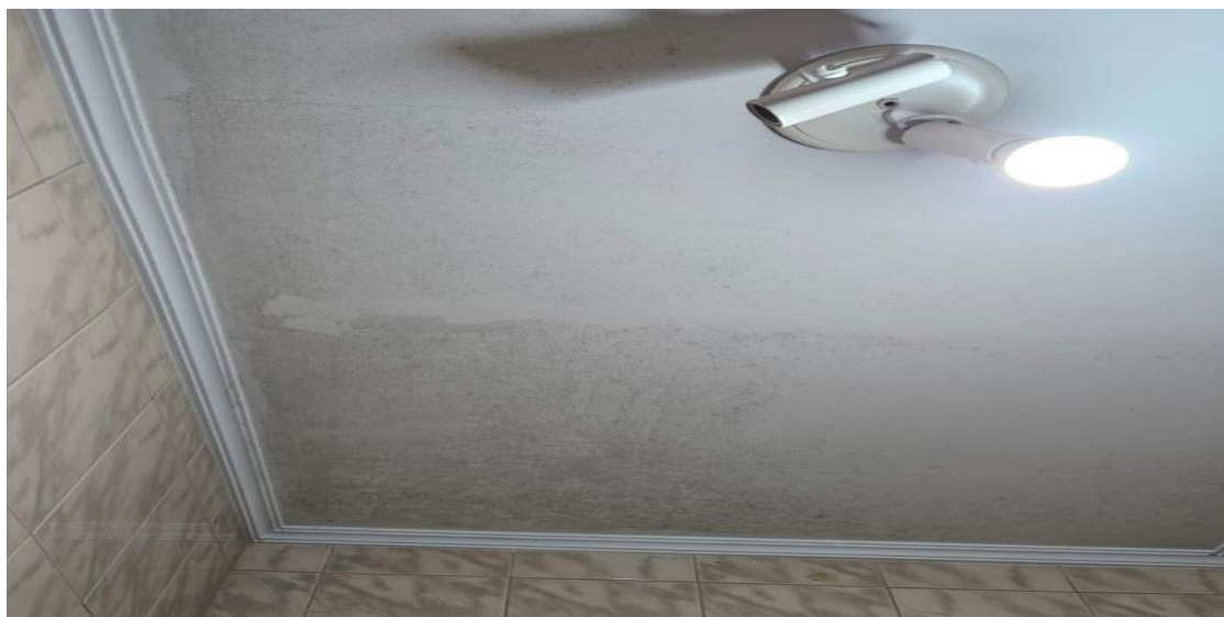
Figura 24: Infiltração na laje de residência.
