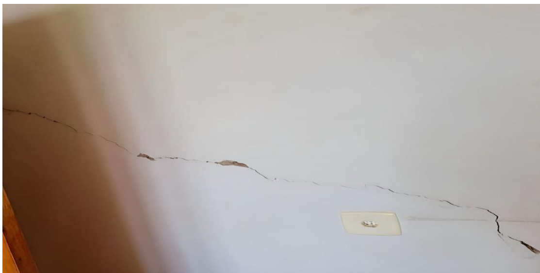
Figura 23: Rachadura em 45° na parede da residência.
