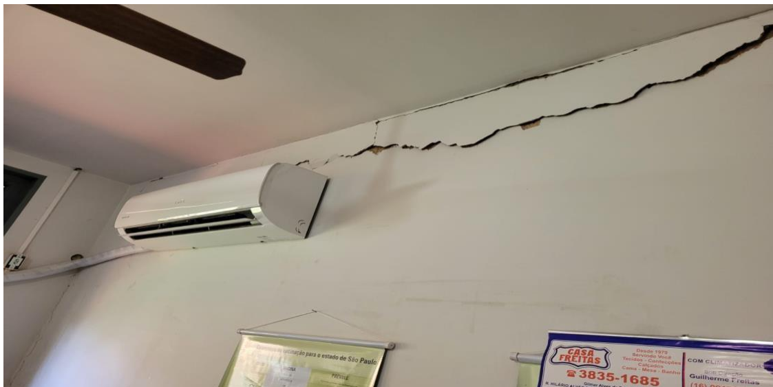
Figura 22: Rachadura na parede da residência.
