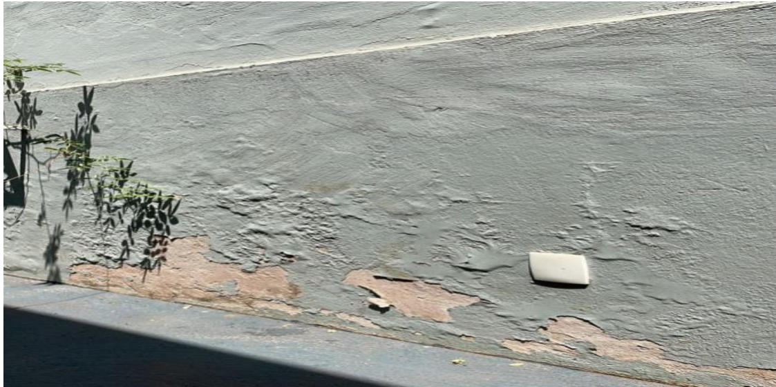
Figura 26: Descascamento na parede externa da residência.
