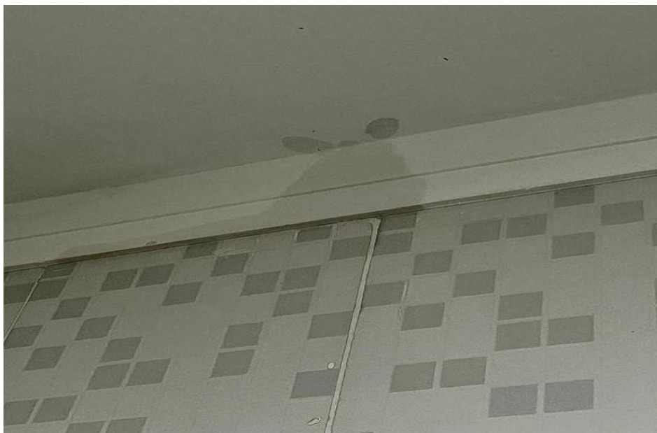
Figura 3: Manifestação patológica devido à condensação.
