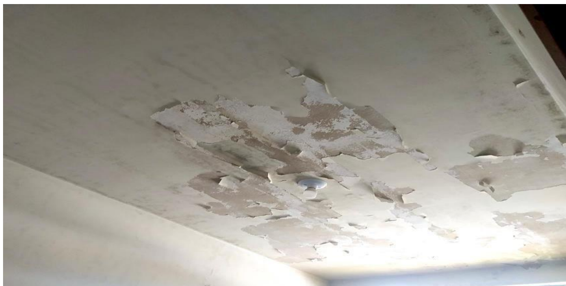
Figura 1: Manifestação de patologia devido à infiltração na laje.
