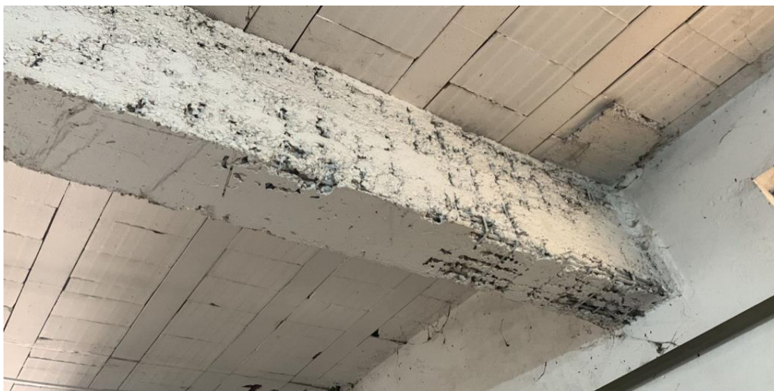
Figura 28: Corrosão de armadura em viga.
