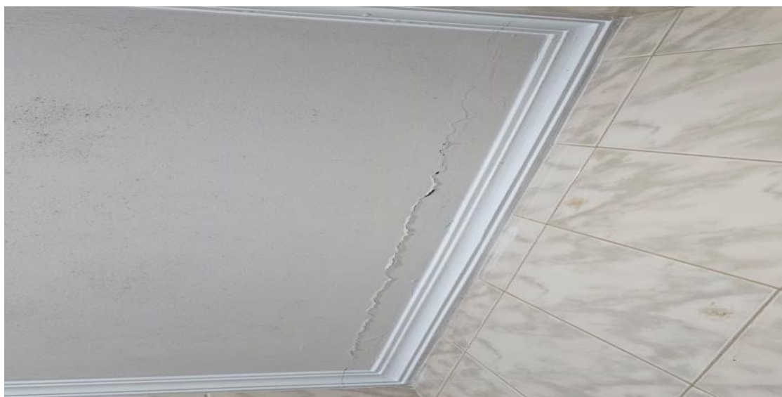
Figura 15: Fissura na laje do banheiro da residência.
