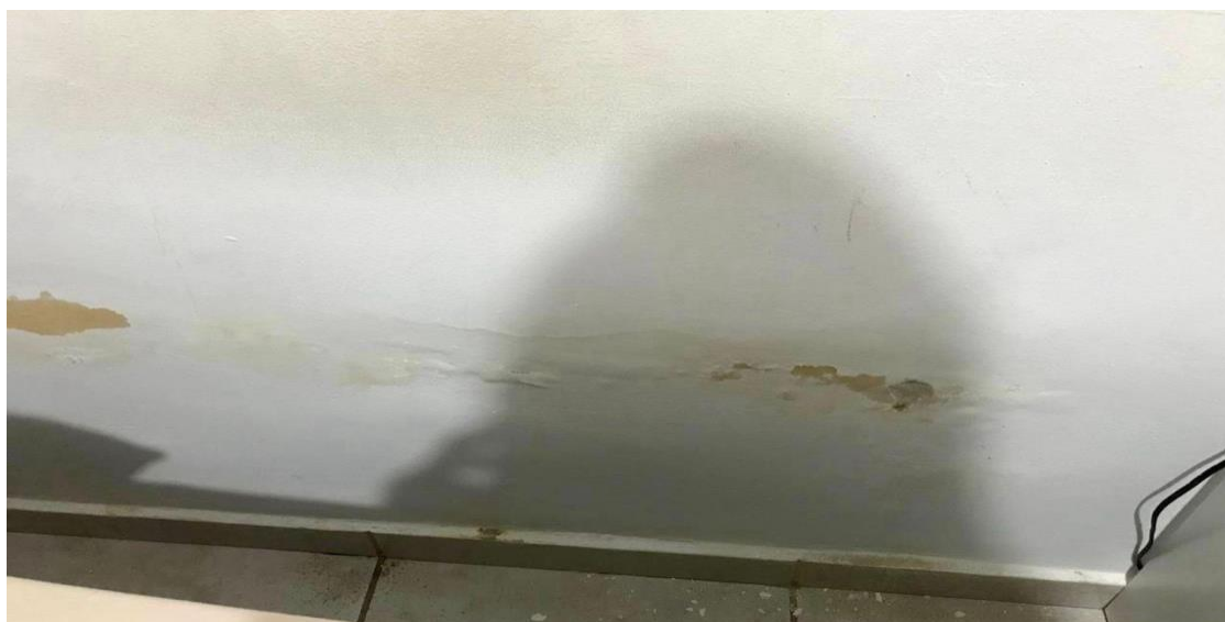
Figura 25 Infiltração na parede da residência.
