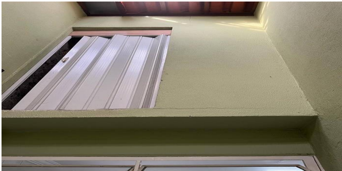
Figura 20: Trinca horizontal na laje.
