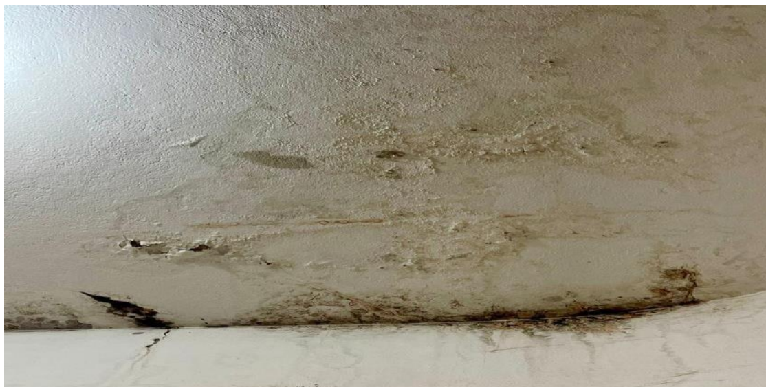
Figura 5: Manifestação patológica devido ao mofo.
