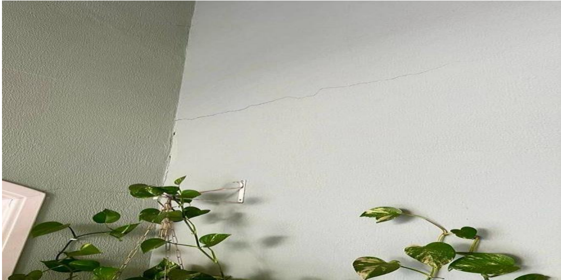
Figura 21: Trinca horizontal na parede.
