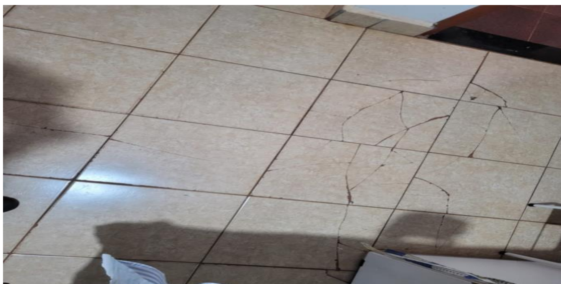
Figura 19: Trinca no piso.
