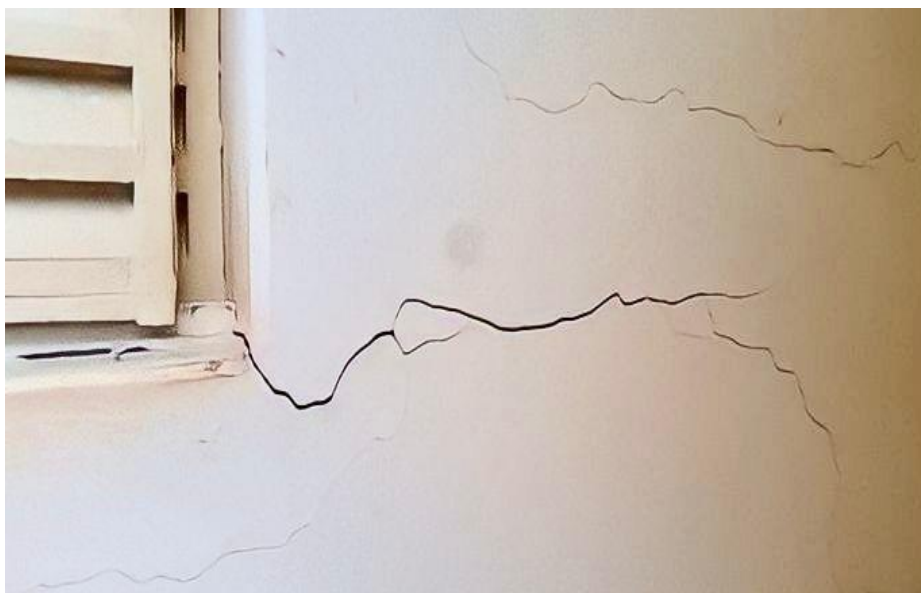
Figura 12: Trinca no canto inferior da janela.
