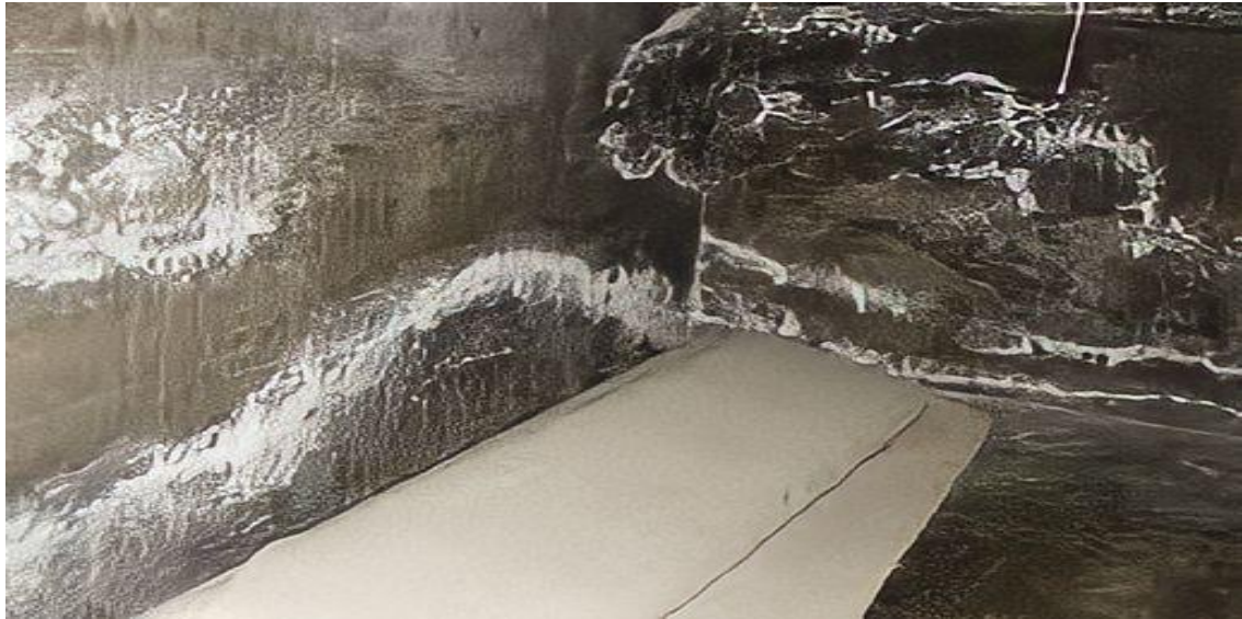
Figura 2: Manifestação patológica devido à eflorescência.
