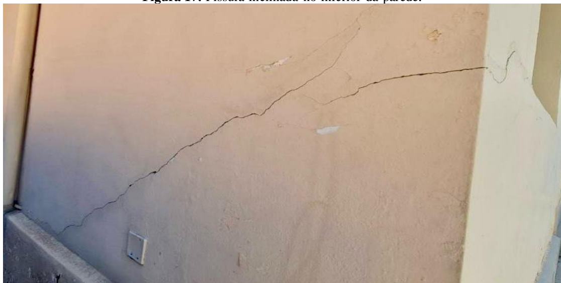
Figura 17: Fissura inclinada no inferior da parede.
