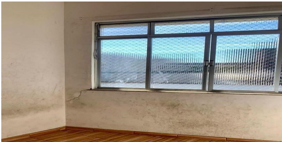
Figura 16: Fissura em 45^\circ no canto da janela.
