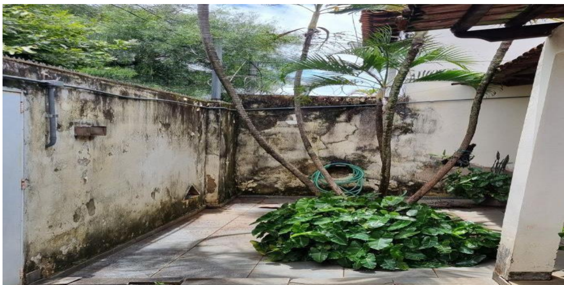
Figura 27: Mofo na parede externa de residência.
