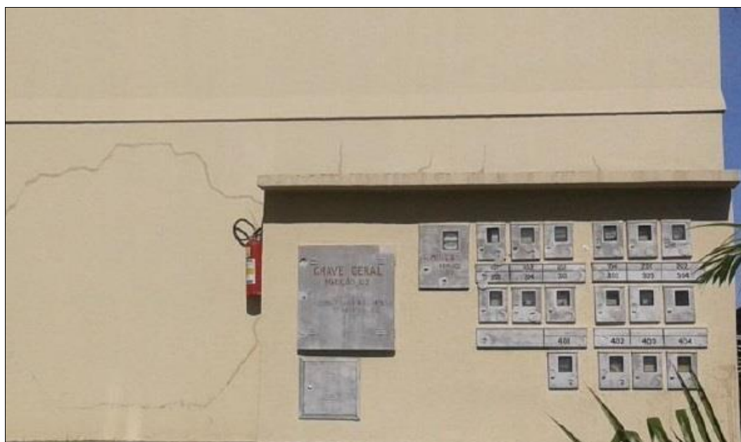
Figura 14: Patologia de argamassa
