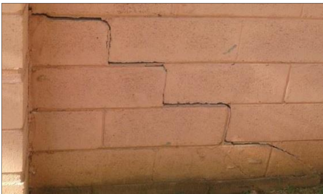
Figura 13: Patologia de junção
