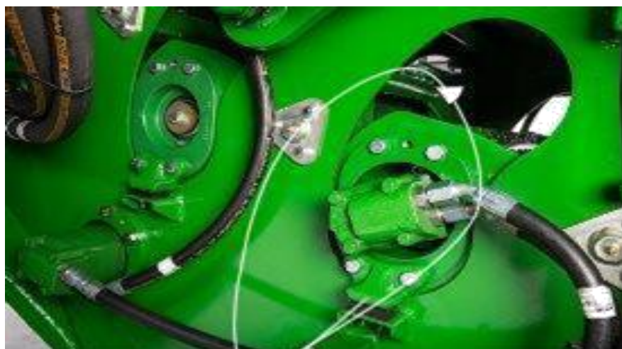
Figura 6 - Bomba e mancal sem blindagem
