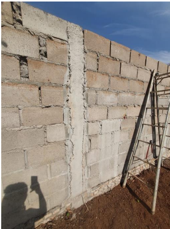
Figura 6 - Muro sem amarração horizontal.
