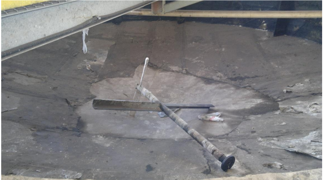
Figura 10 - Tanque de decantação.
