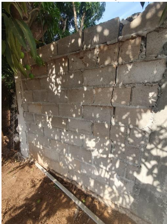
Figura 5 - Muro sem amarração horizontal
