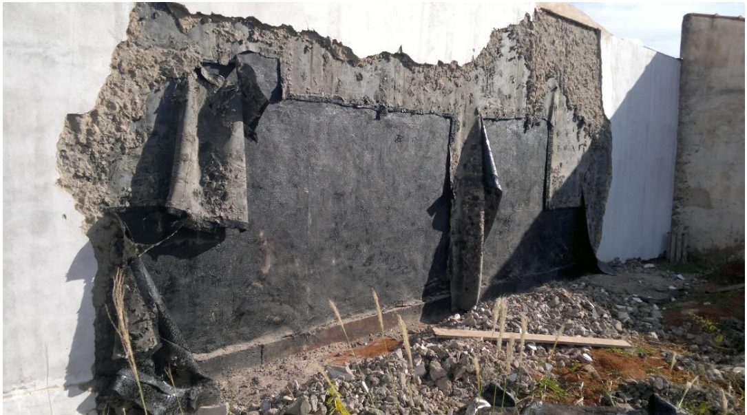
Figura 11 - Deslocamento da manta asfáltica.
