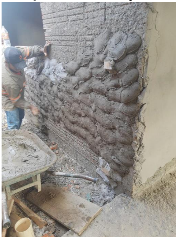
Figura 2 - Parede fora do prumo.
