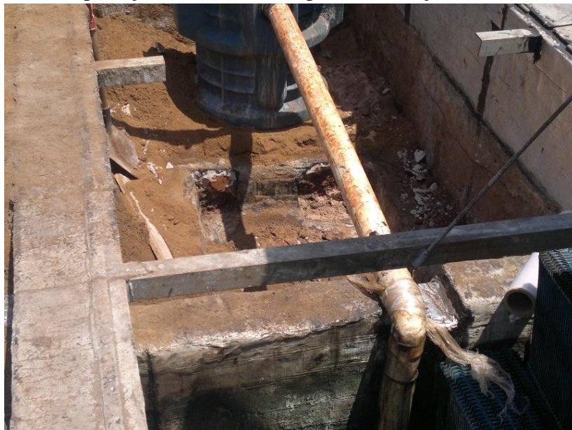
Figura 9 - Falta de proteção mecânica da impermeabilização de filtros de decantação.
