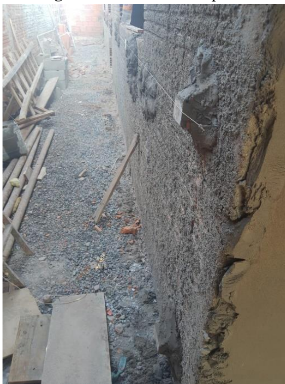
Figura 1 - Parede fora do prumo
