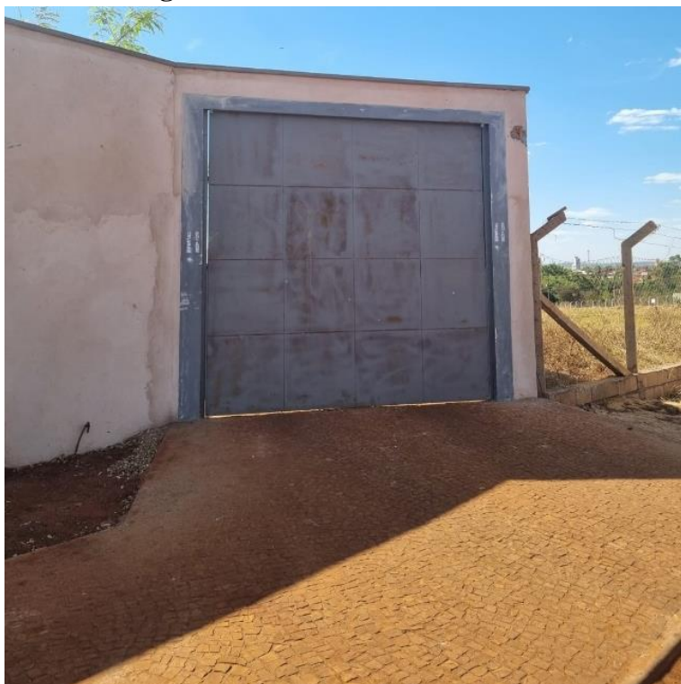
Figura 7 - Portão mal dimensionado.
